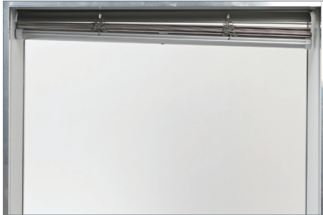
Jalousie montiert / Lamellenpaket nicht ausgerichtet
