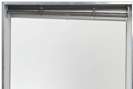
Jalousie montiert / Lamellenpaket nicht ausgerichtet
